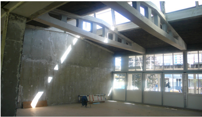
Poutres Viereendeel dans un bâtiment de travaux pratiques en cours de travaux
