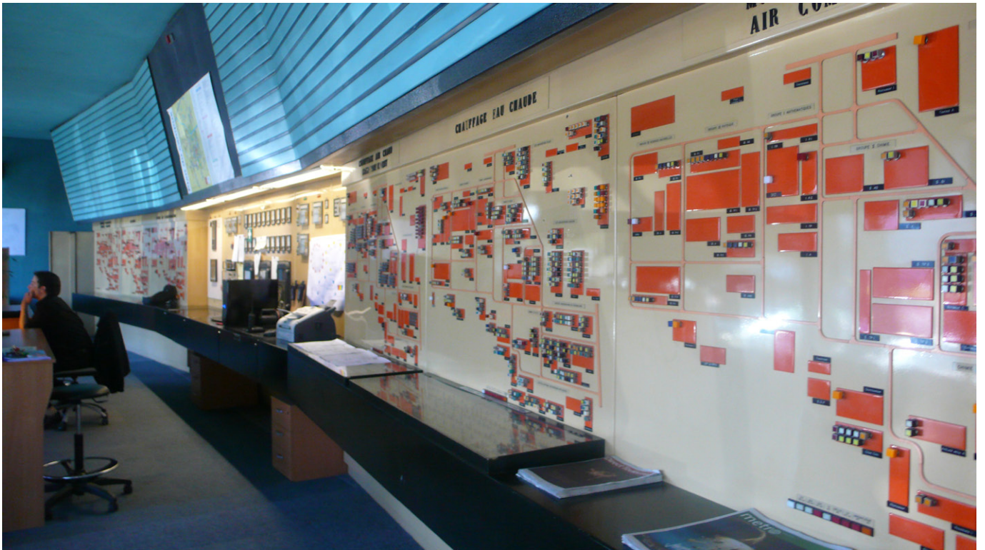
Salle de contrôle dans le bâtiment du SGE
