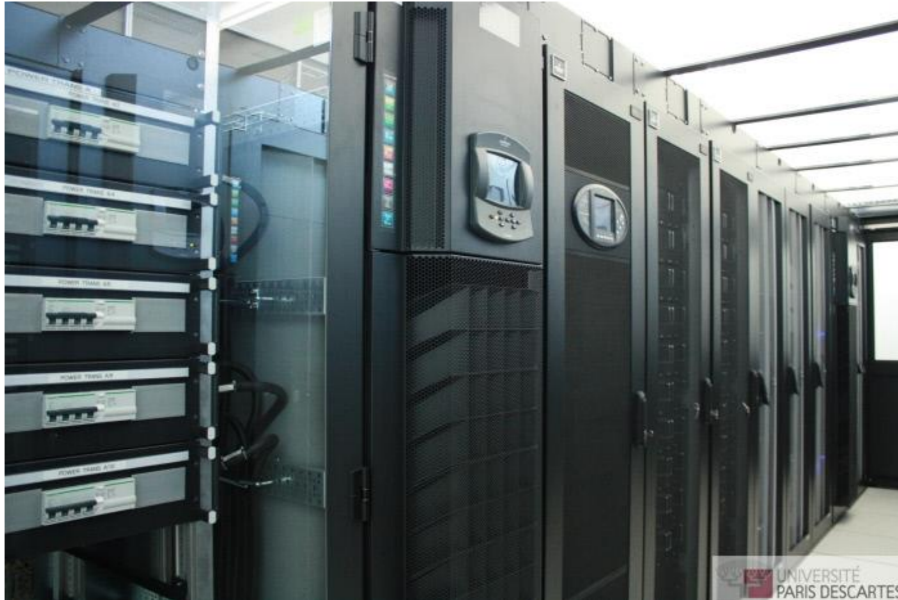
Salle Broca, le datacenter de l'université Descartes Source : phototheque.parisdescartes.fr
